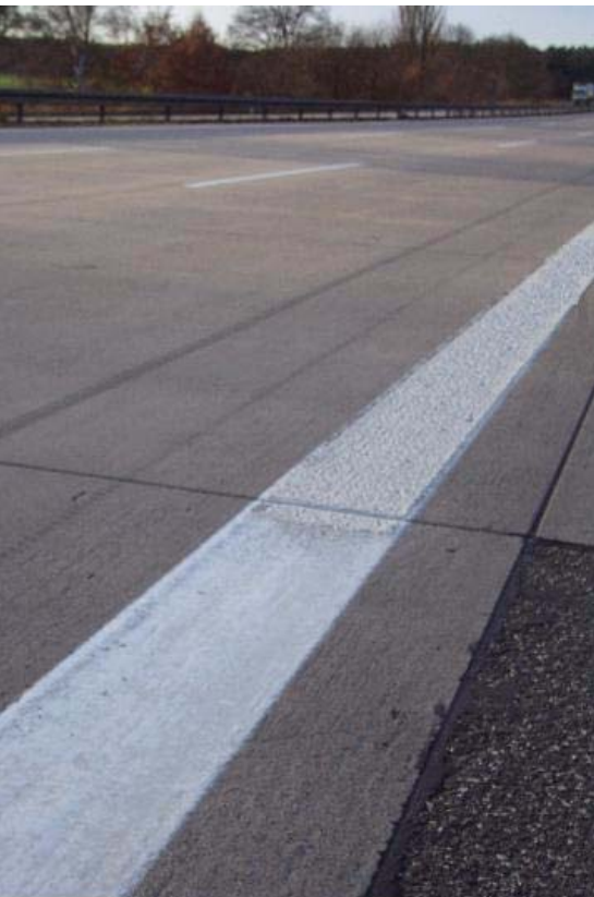
Übergang Randmarkierung Farbe/ KP Agglomerate auf der BAB A 2 bei Tag, Richtungsfahrbahn Hannover, km 12,5
