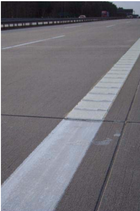
Passage du marquage de bord Peinture / Profil transversal KP à 90° sur l'autoroute A2 de jour, Voie direction Hanovre, km 15,3
