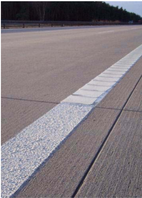
Passage du marquage de bord agglomérats KP / profil transversal KP à 90° sur l'autoroute A2 de jour, Voie direction Hanovre, km 13,5
